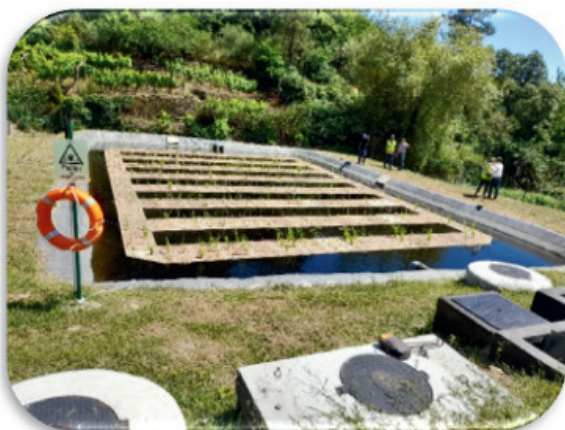
FOTO 3 - ETAR DE TABUADELO (SANTA MARTA DE PENAGUIÃO)
