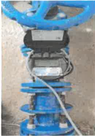
Foto 6 - Medição de caudal em ZMC
