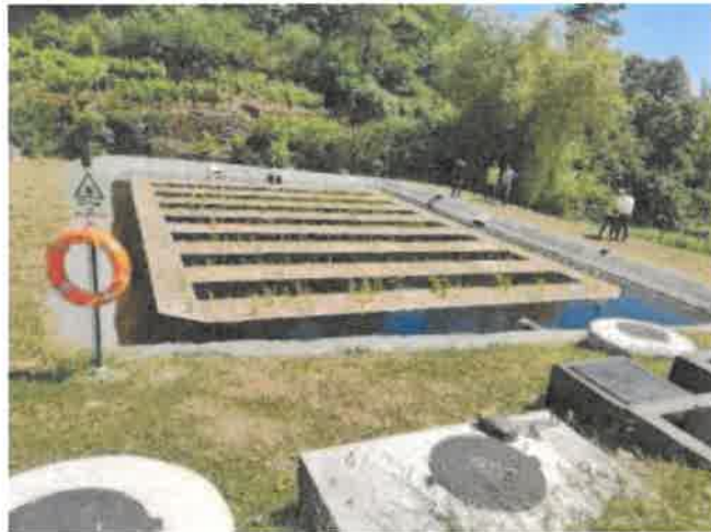
Foto 3 - ETAR de Tabuadelo
