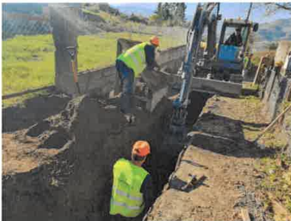
FOTO 2 - FECHO DE SISTEMAS DE ÁGUAS RESIDUAIS EM VÁRIOS LUGARES DO MUNICÍPIO DO PESO DA RÉGUA
